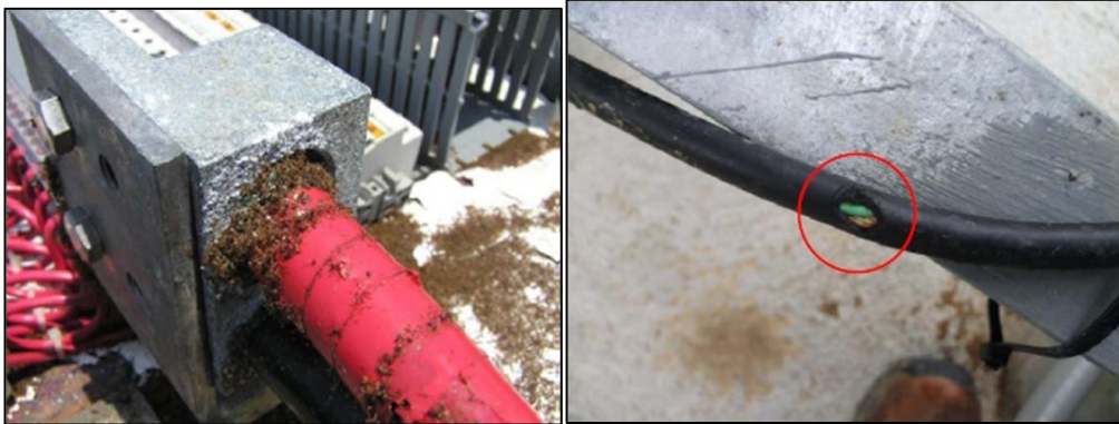
Figure II-10: Exemples de défauts rencontrés dans le système de câblage[12]
