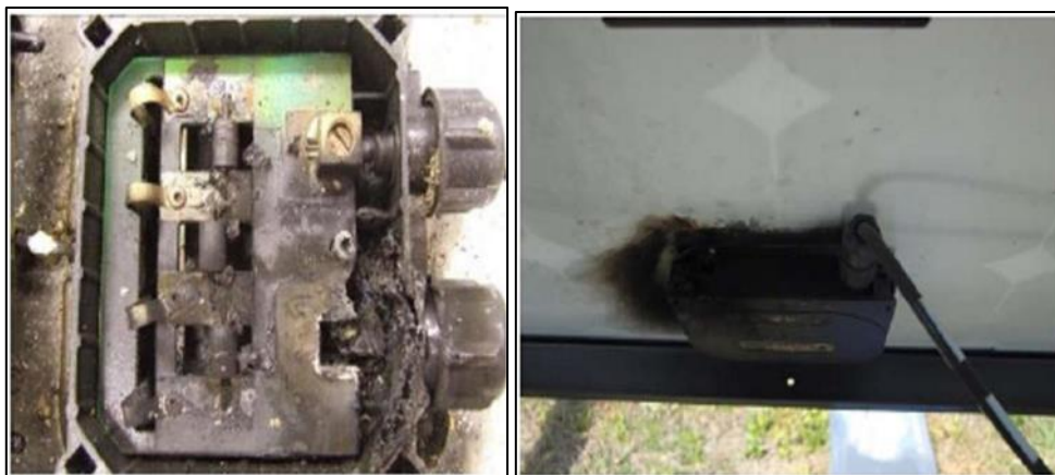
Figure II-9: Exemples de défauts rencontrés dans des boîtes de jonction[17]
