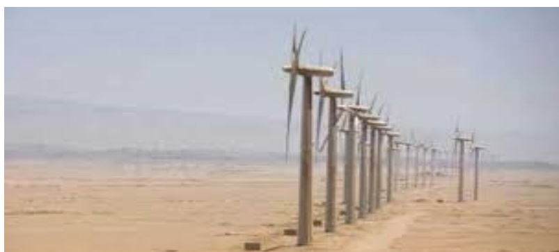
Figure I.7: 1er Ferme éolienne en Algérie [23].
