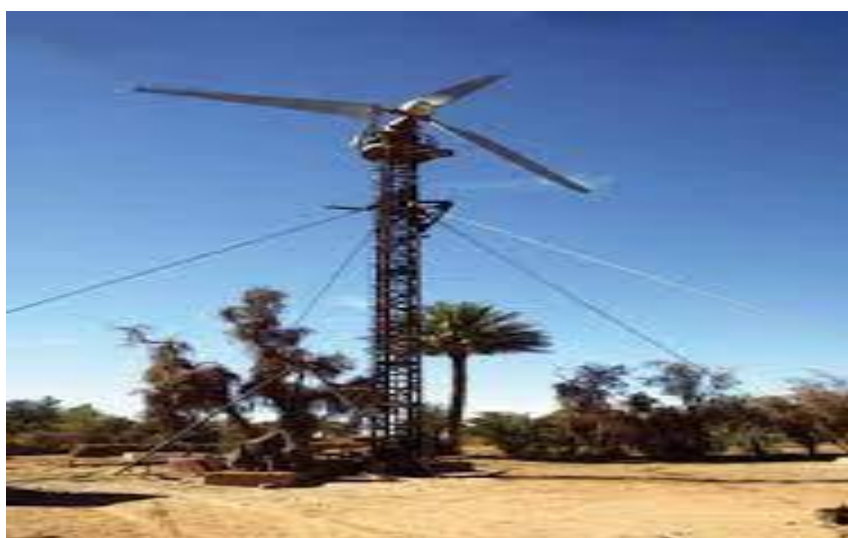
Fig 1.16 : la première éolienne installée en Algérie
